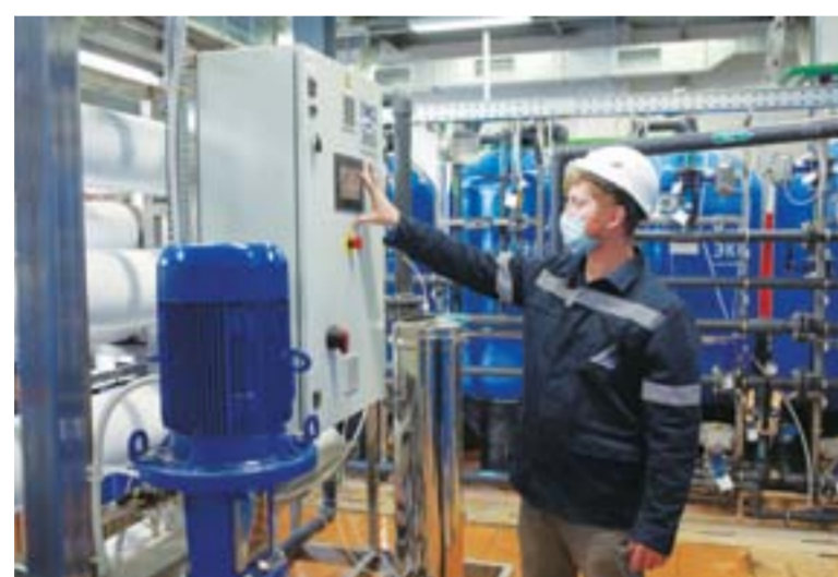
Для обеспечения необходимых технических условий работы линии введены в строй участок фильтрации и индивидуальный тепловой пункт
